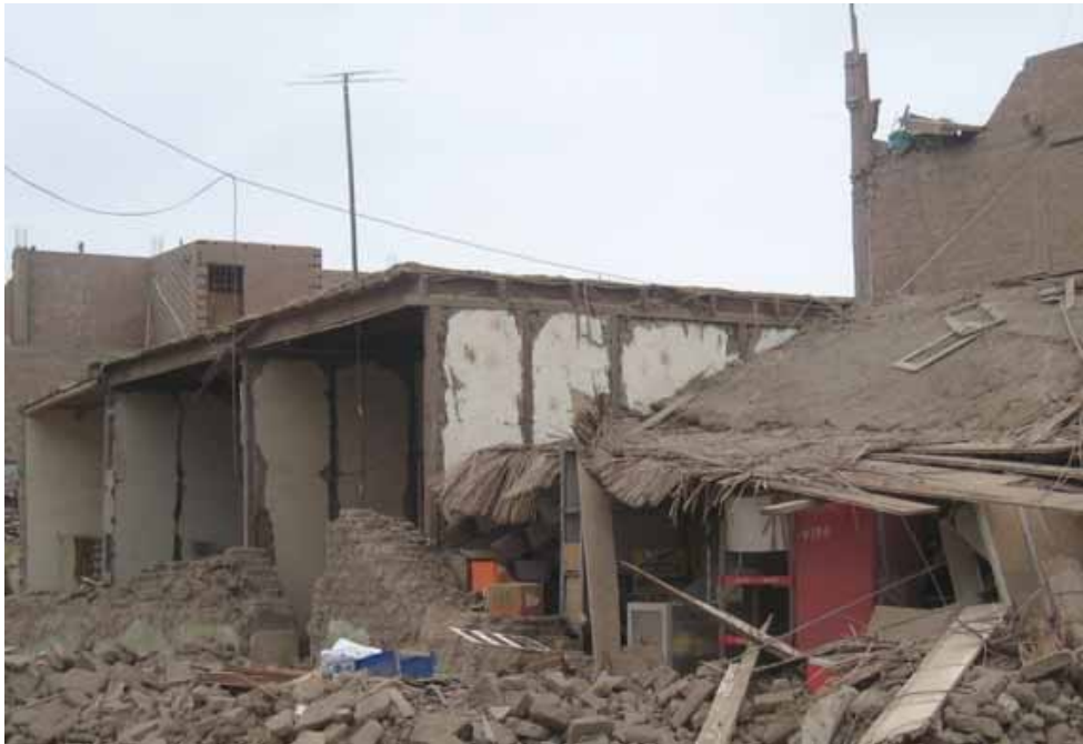
Figura 2.- Casas de adobe colapsadas en Pisco. Las vigas del techo de la casa de la derecha estaban apoyadas sobre las divisiones de quincha. Las vigas del techo de la casa de la derecha estaban apoyadas sobre la fachada de la pared, por lo tanto colapsaron con la fachada. Nótese a la izquierda la casa construida de material noble sin daños y en la parte posterior derecha el colapso de la fachada de una casa.
